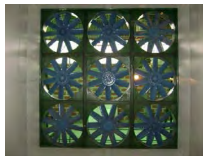
Figura 4: Vista frontal de los 9 ventiladores.
